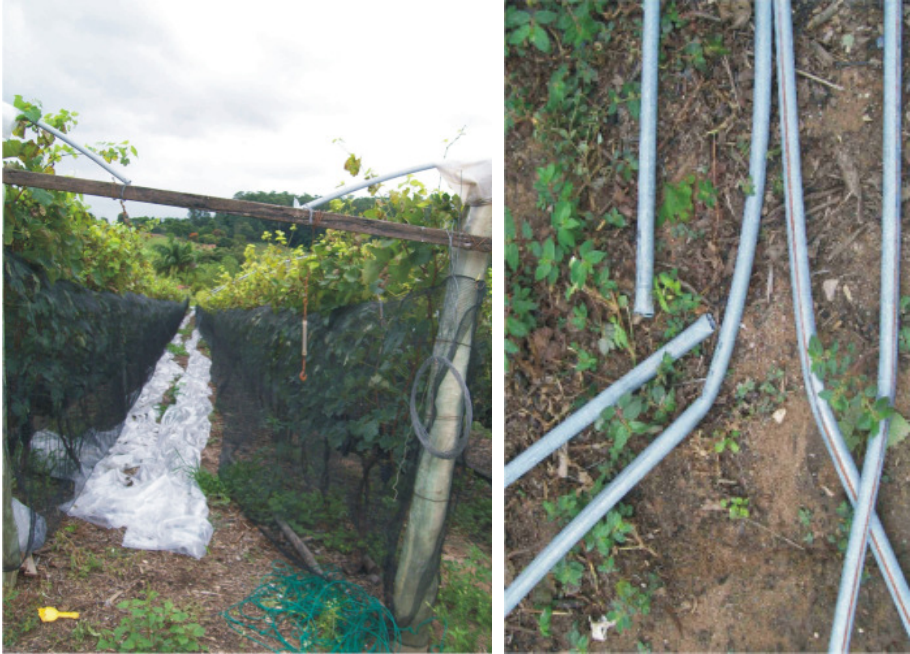
Figura 31. Dano causado pelo vento em área cultivada com a variedade Syrah, em espaldeira sob cultivo protegido. O plástico precisou ser cortado para evitar prejuízo maior à estrutura de canos de ferro.
